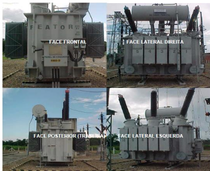
Figura 1: Reator elétrico trifásico 30 MVar – 242 MVA.
