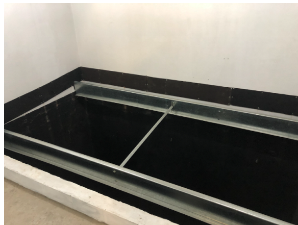
Figura 2: Espaço para instalação das amostras.
